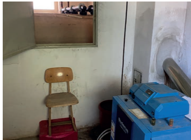
Heizung / Tanks im Untergeschoss
