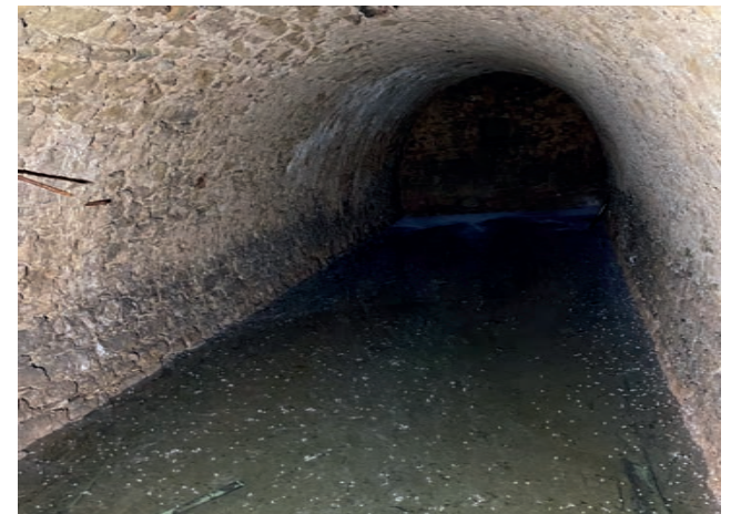
Gewölbekeller - Wasser im Keller
